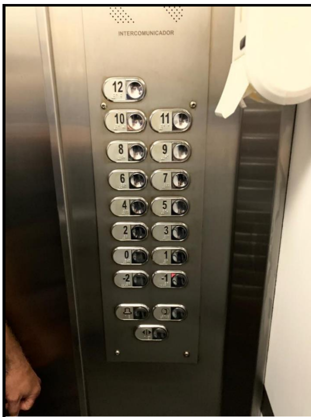
Foto 11: Pannel do elevador
