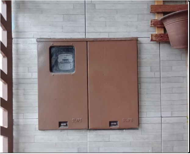
MEDIDOR DE ENERGIA
