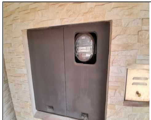
MEDIDOR DE ENERGIA ELÉTRICA
