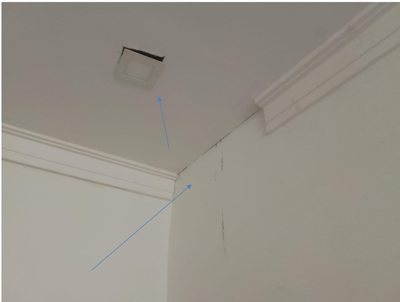
TETO DA SALA DO APARTAMENTO 126B – 12º ANDAR.
