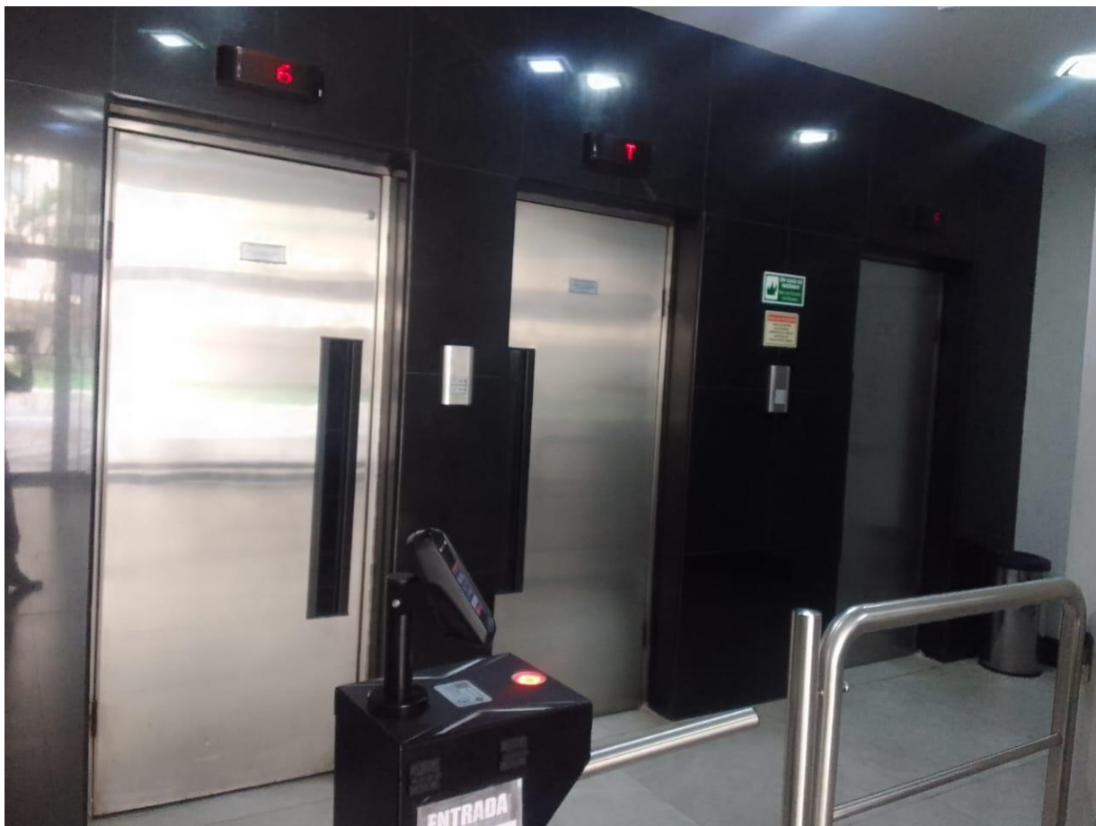
FOTO17. ELEVADORES – 2 SOCIAIS E 1 DE SERVIÇO. NÃO UTILIZADO PELO PROPRIETÁRIO / USUÁRIOS.
