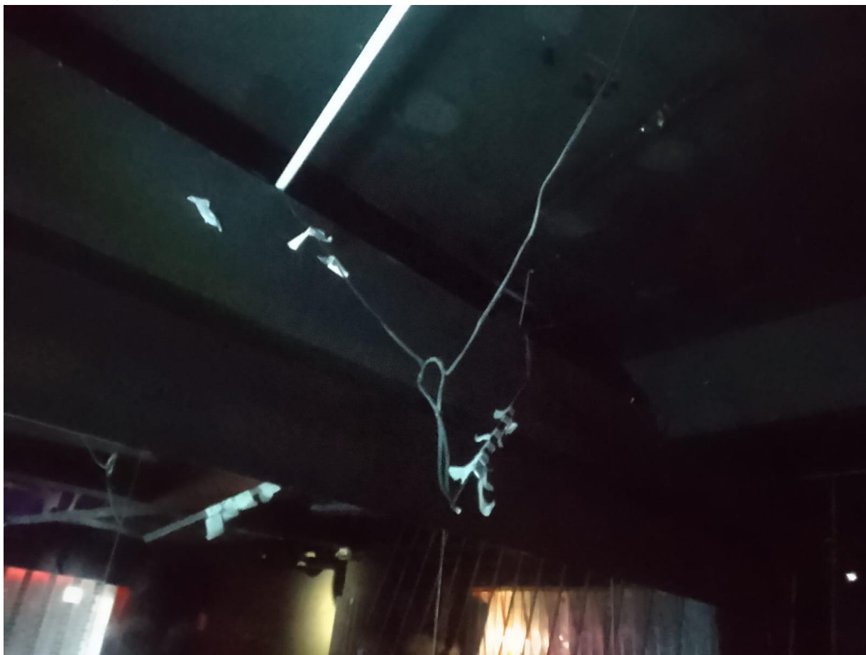
Foto 9. FIAÇÃO EXPOSTA (SOLTA) NA PRIMEIRA SALA – LOJA Nº 5.
