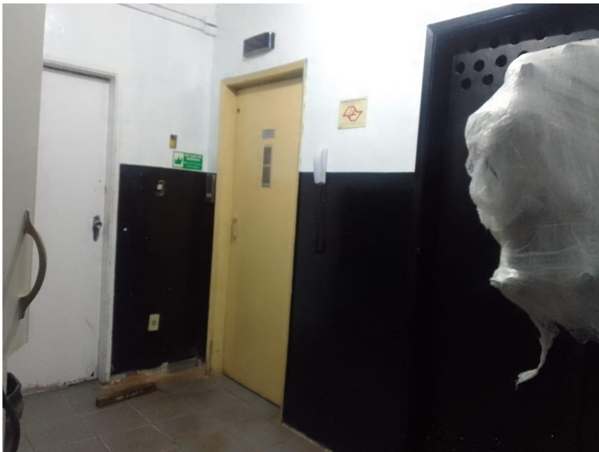
FOTO16, ELEVADOR DE SERVIÇO CHEGA ATÉ LOJA Nº 5 . NÃO UTILIZADO PELO PROPRIETÁRIO /USUÁRIOS.
