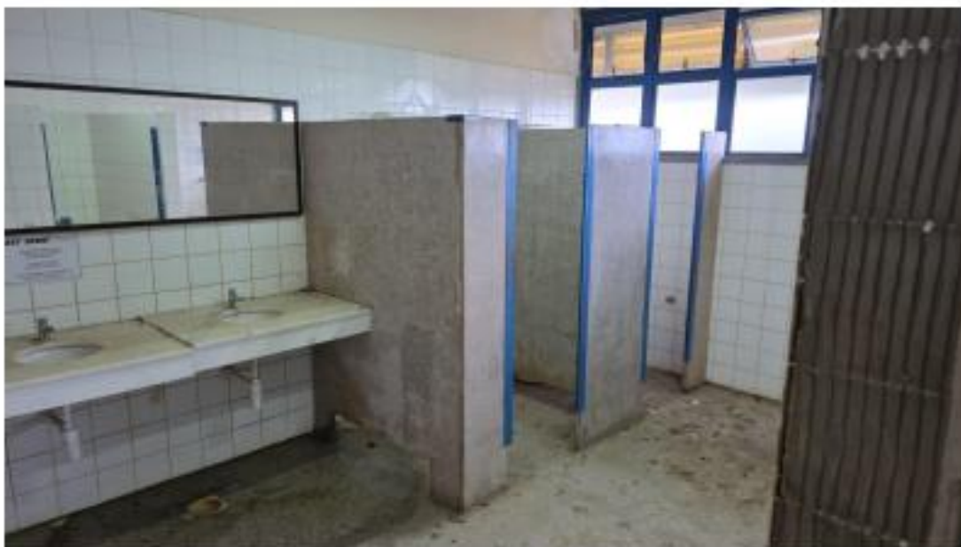
Foto 39: módulo saúde – banheiros
